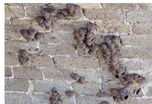
Mehlschwalbennester unter einer Brücke (Foto: Gunter Halle)
