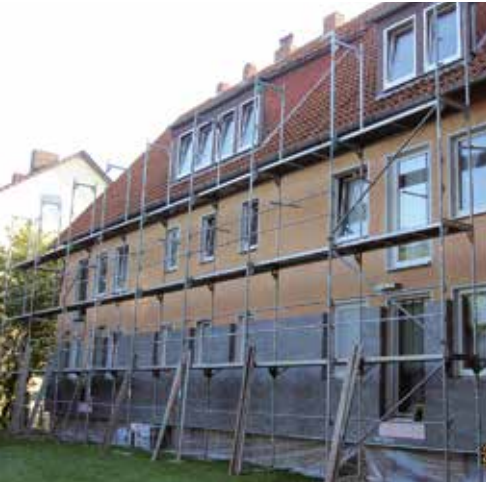
Durch Baugerüste dürfen Schwalben nicht bei der Brutpflege beeinträchtigt werden (Foto: Kerstin Bosse)
